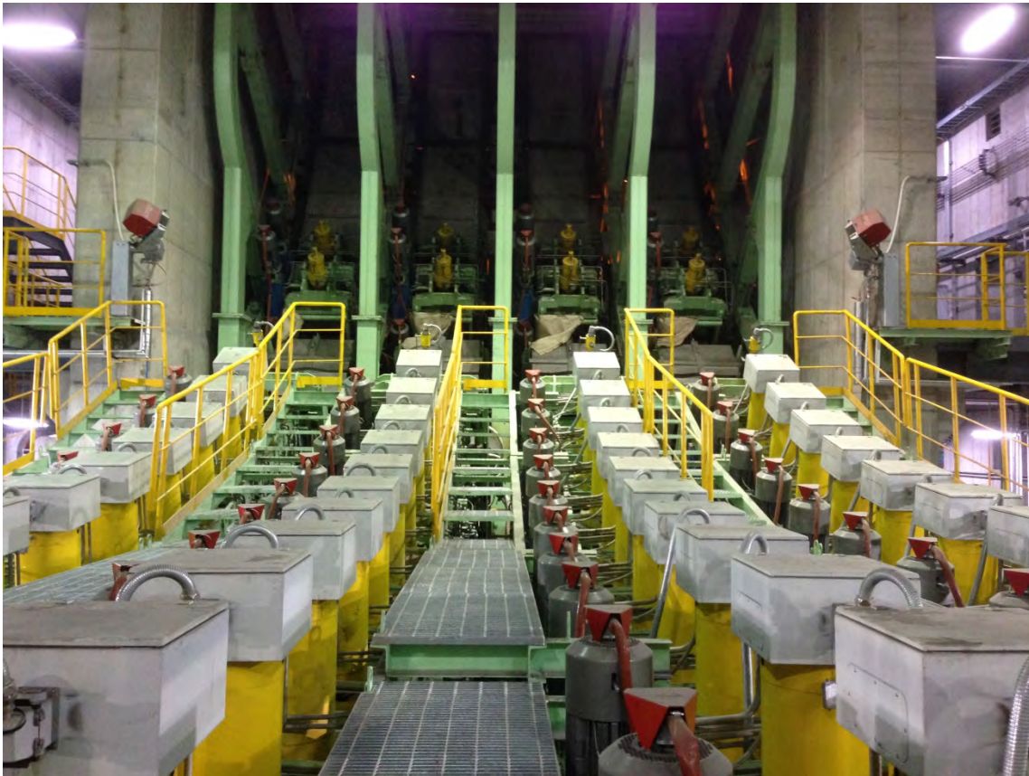
現代スチールの韓国・唐津工場にプライメタルズ テクノロジーズが納入したブルーム連続鋳造機。
