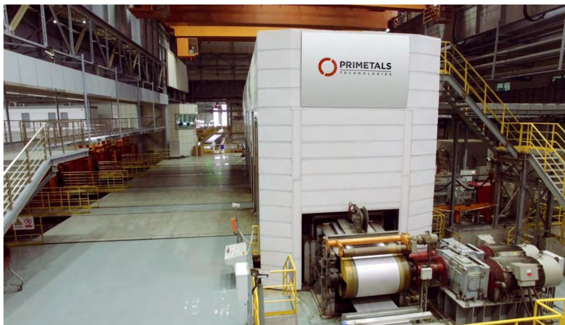
Primetals Technologies が唐山鋼鉄集団に納入した冷間圧延機
